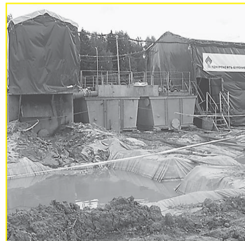
Очистное оборудование на буровой.
